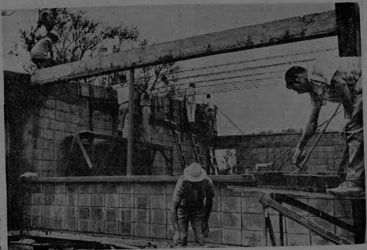
Vista parcial en donde se puede observar a los trabajadores de las Construcciones Lamm Ltda., en plena actividad.
